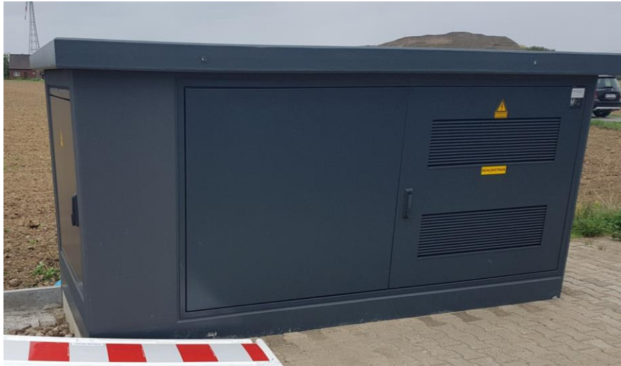
Referenzbild neuer Trafo
